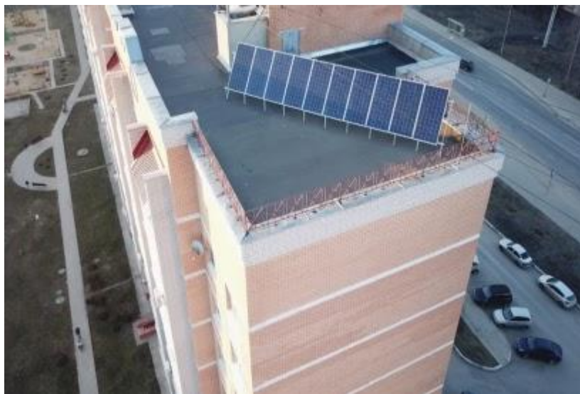
Солнечные панели на крыше дома
